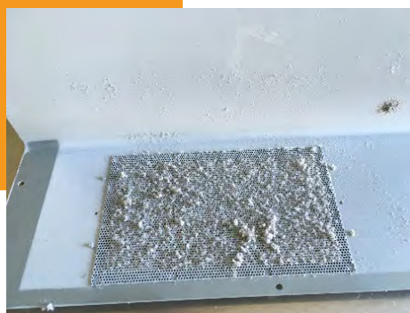
Fig. 14 Grelha de ventilação não limpa nem mantida.
